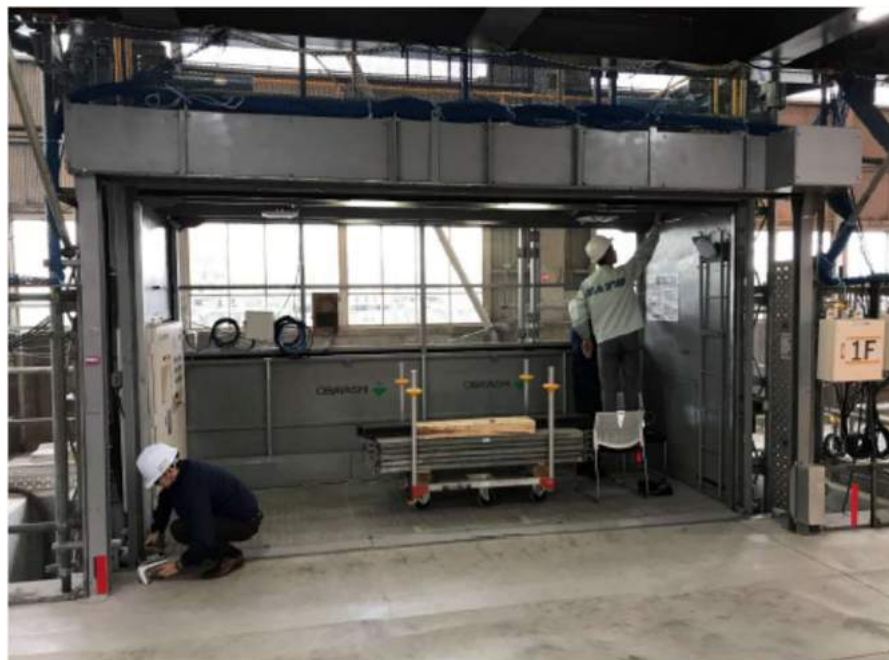
アンテナ・タグの取付状況
