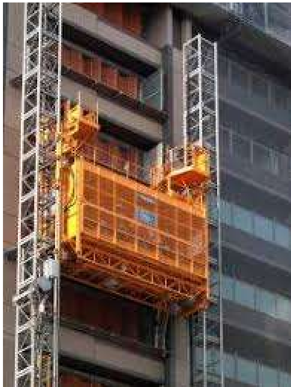
工事用エレベーター
